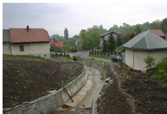
Wprowadzenie Wieśnika w betonowy żłób będzie skutkowało istotnym wzrostem zagrożeń powodziowych.
