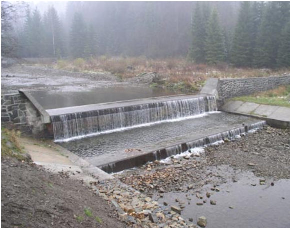
Remont stopni w rejonie rezerwatu powołanego dla ochrony przystępu jest sprzeczny z celem w jakim został on utworzony. Fot. TnZ/Konrad Kata
