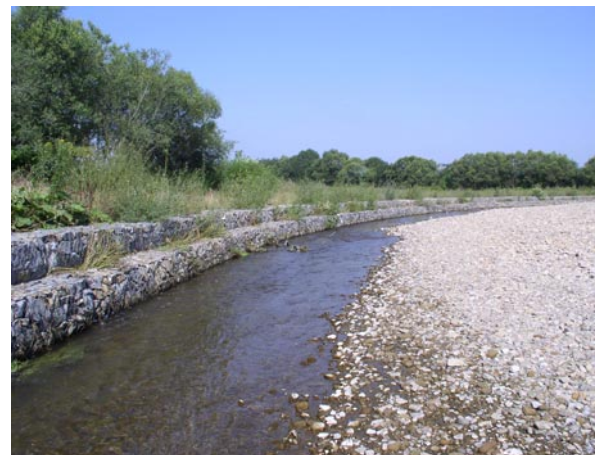
Wykonane kosze siatkowo-kamienne to obiekty dalekie od deklarowanych, proekologicznych rozwiązań.
